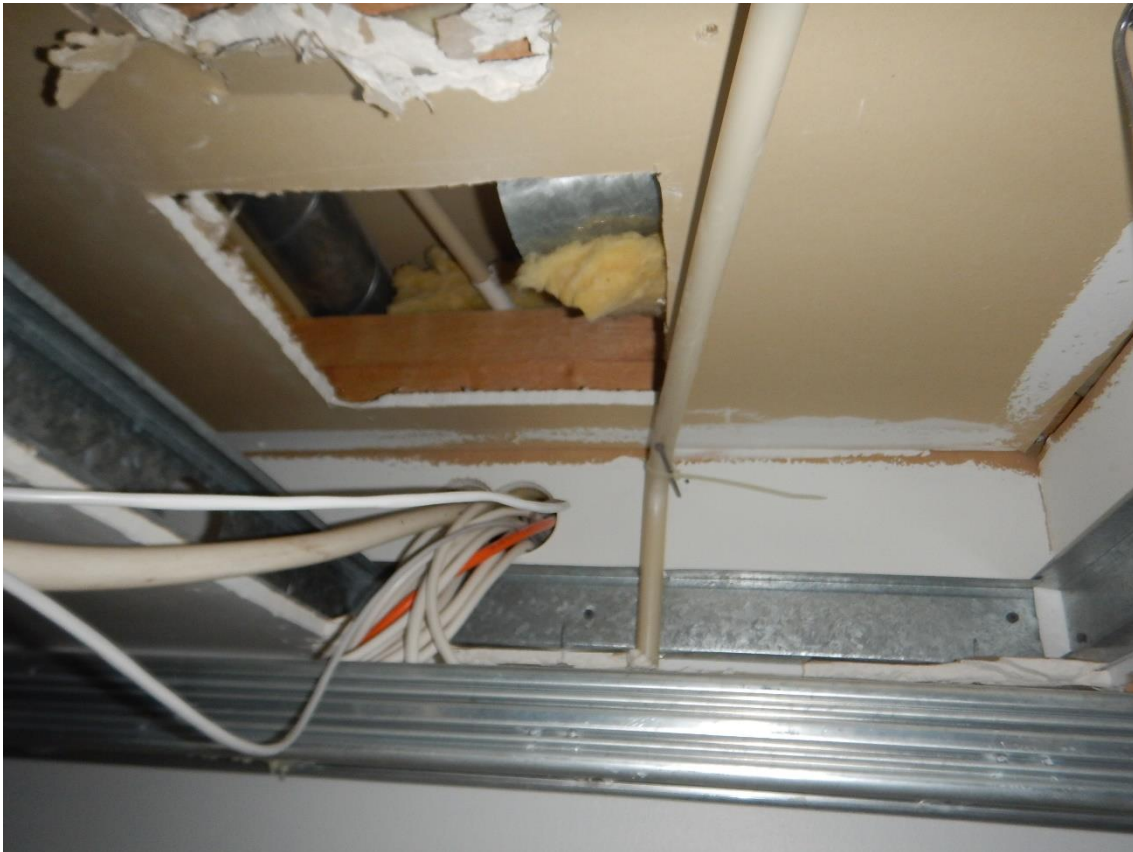
Kuva 93. Eskaritilan välikatossa on avoimia levysaumoja korjaus ja muutostöiden jäljiltä sekä mineraalivillaa ilmatilassa.
