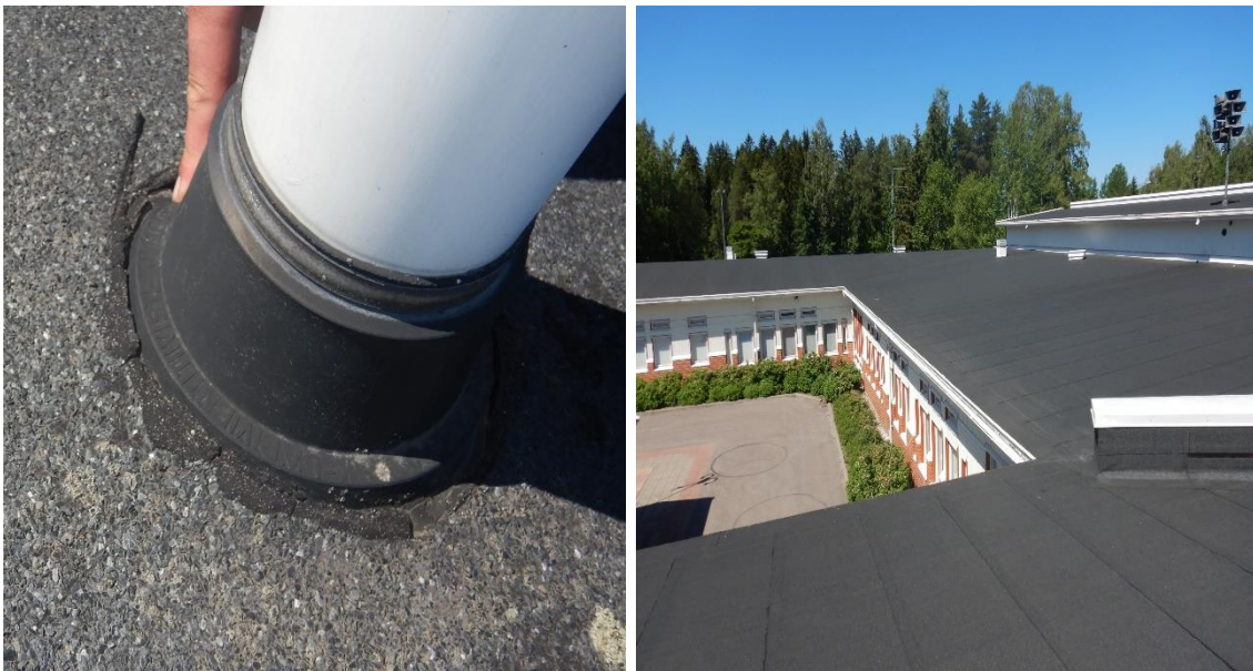
Kuva 71. Huopakate pääosin hyvässä kunnossa, mutta läpivientien kohdalla havaittiin paikoin rakoja, josta vesi voi päästä yläpohjarakenteisiin.
