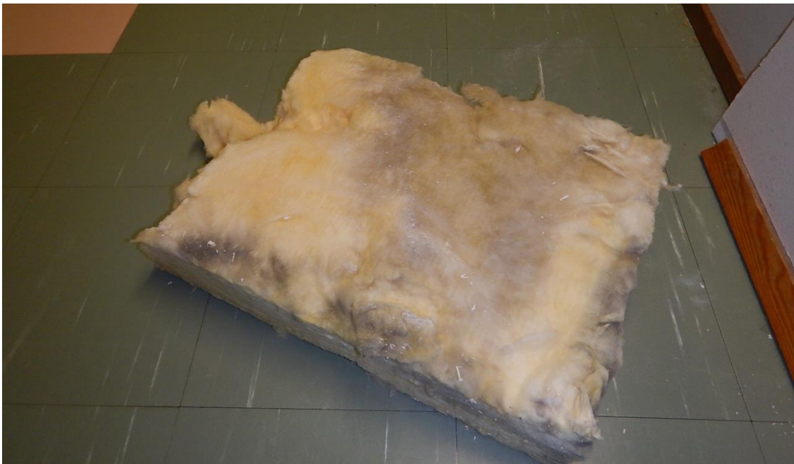
Kuva 42. Väliseinän mineraalivillassa (VS1.1.) oli vahvaa tummentumaa, mikä viittaa mikrobivaurioon.
