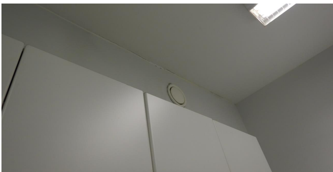
Kuva 106. Poistoilmalaitteet puhtaita ja esteetön ilman liikkuvuus.
