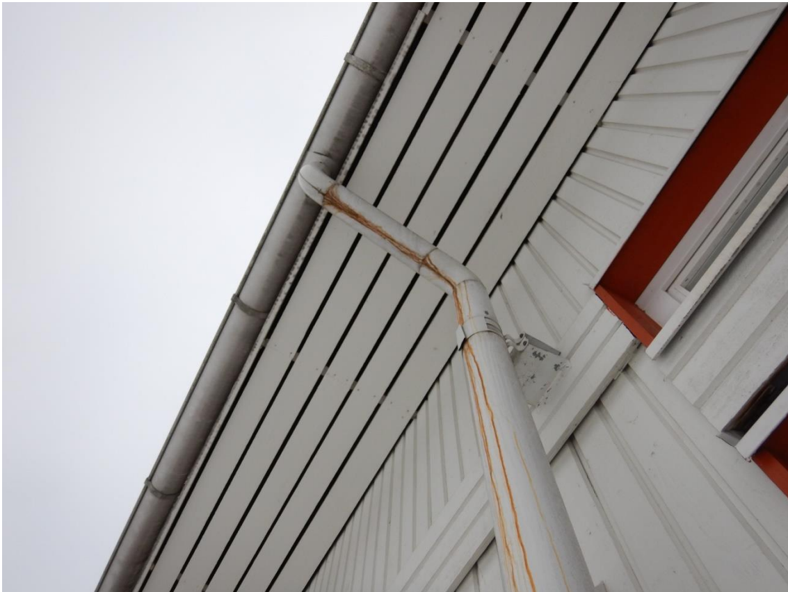
Kuva 75 Syöksytörven liitos vuotaa ja räystäslaudoituksen sekä rännin välistä valuu vesi
