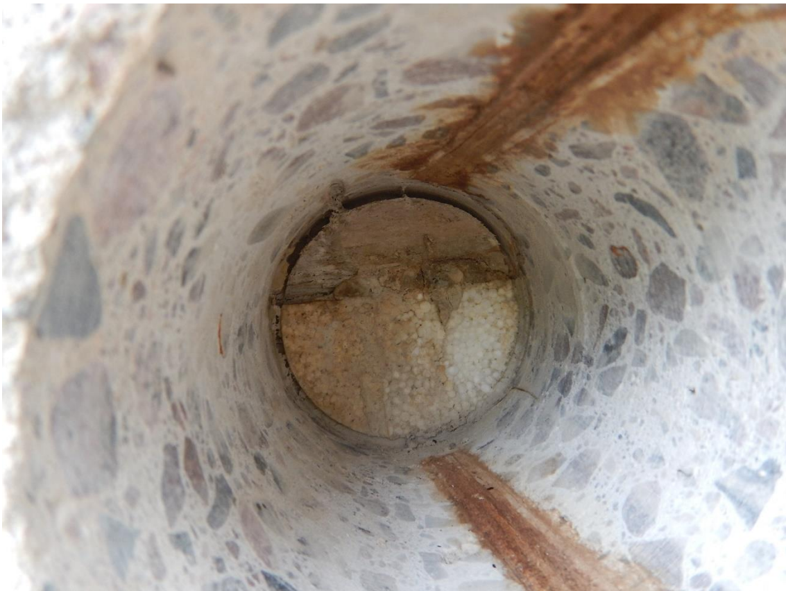
Kuva 51. Sokkelin kuorivalun liikuntasauvan vanerilevy vettynyttä ja mikrobivaurioitunutta
