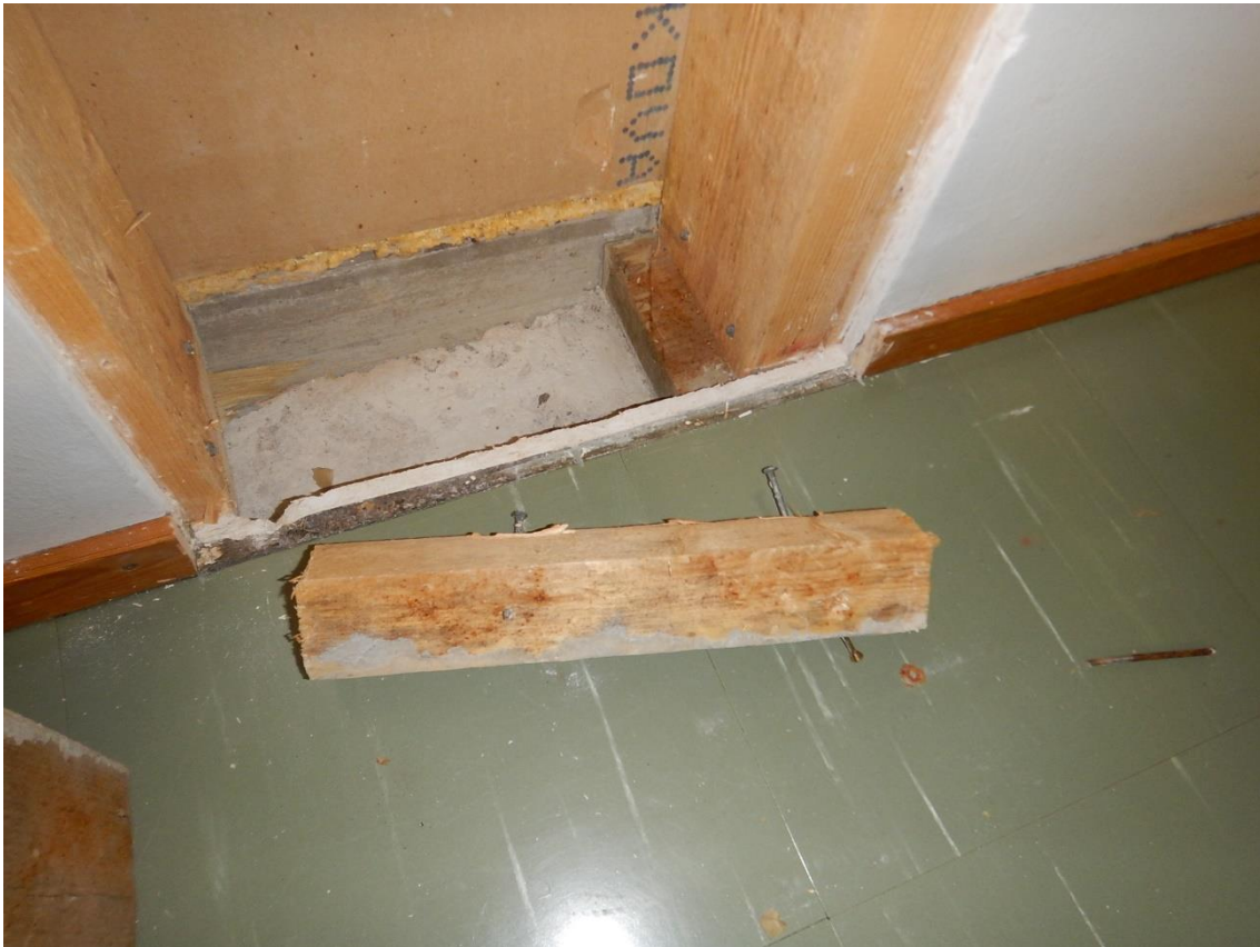
Kuva 41. VS1.1 avauksessa havaittiin ruosteisia nautoja alajuoksussa tummentumaa.
