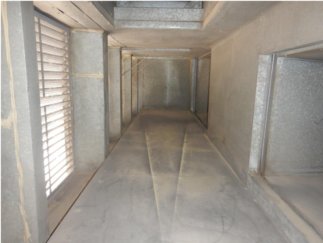
Kuva 102. Useamman konetta palveleva tuloilmakammio vaikutti puhtaalta.
