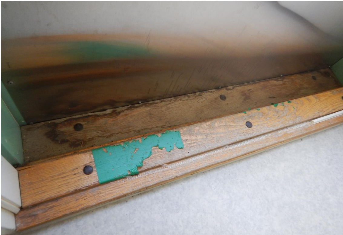
Kuva 62. Talonmiehen asunnon sivuoven kynnyksessä kosteusvaurioitunut.
