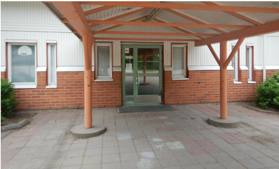
Kuva 6. Sisäänkäyntien korko on matala ja vedellä pääsy kynnyksrakenteisiin.
