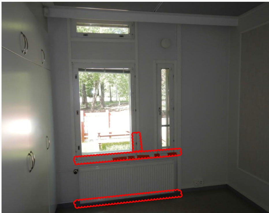
Kuva 118. Havaittuja ilmayvuotokohtia Ryhmähuoneessa T4.
