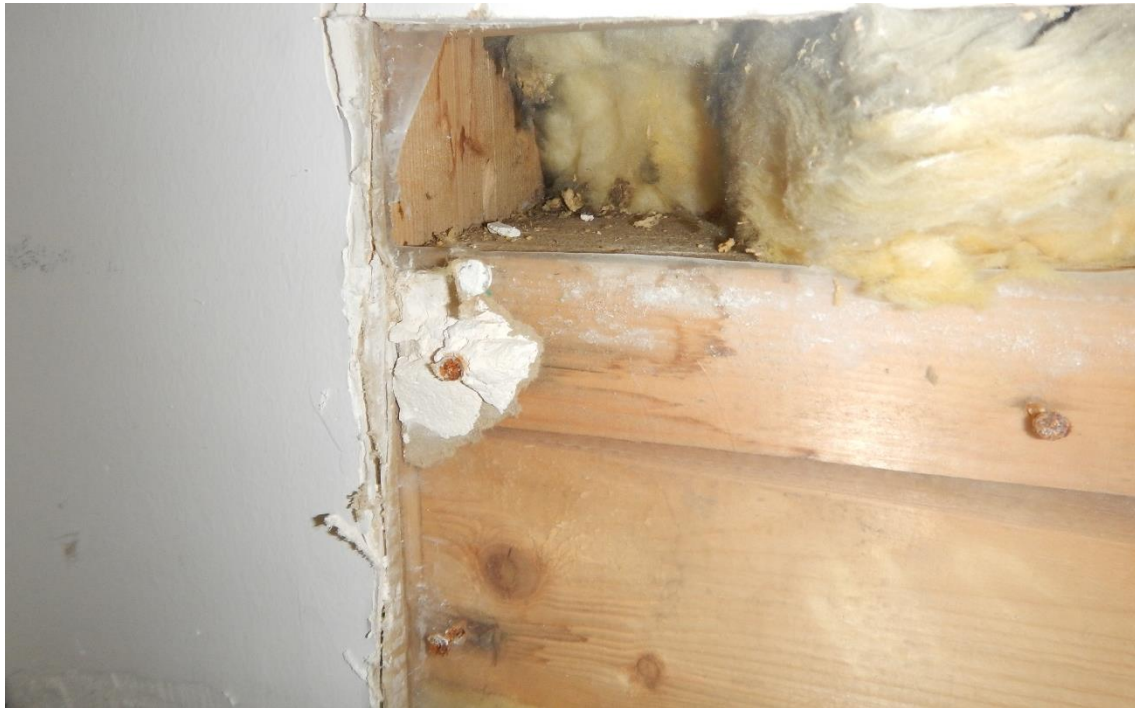
Kuva 58. Rakenneavaus tekstiilityön luokan ulkoseinään - kiinnitysnaulat ruosteessa ja runko- puissa valumajälkiä.
