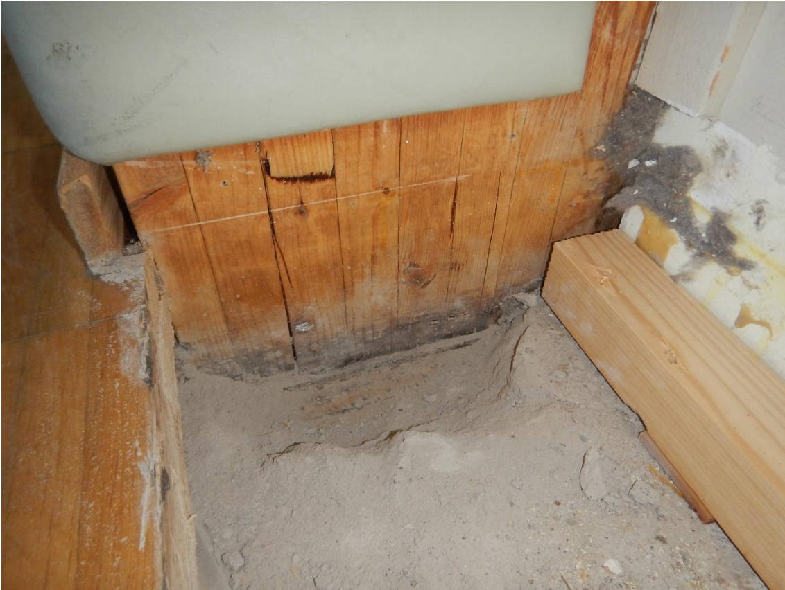
Kuva 29 Pilarin juuri lattiabetonin sisässä. Pilarissa tummentumia.
