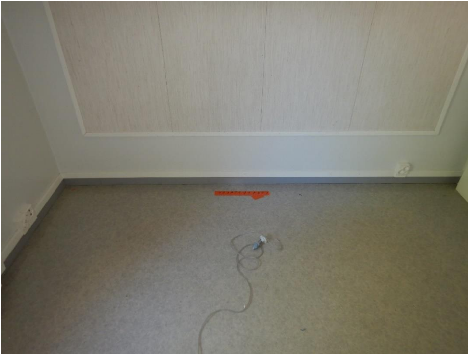
Kuva 119. Havaittuja ilmapuotokohtia Ryhmähuoneessa T4.
