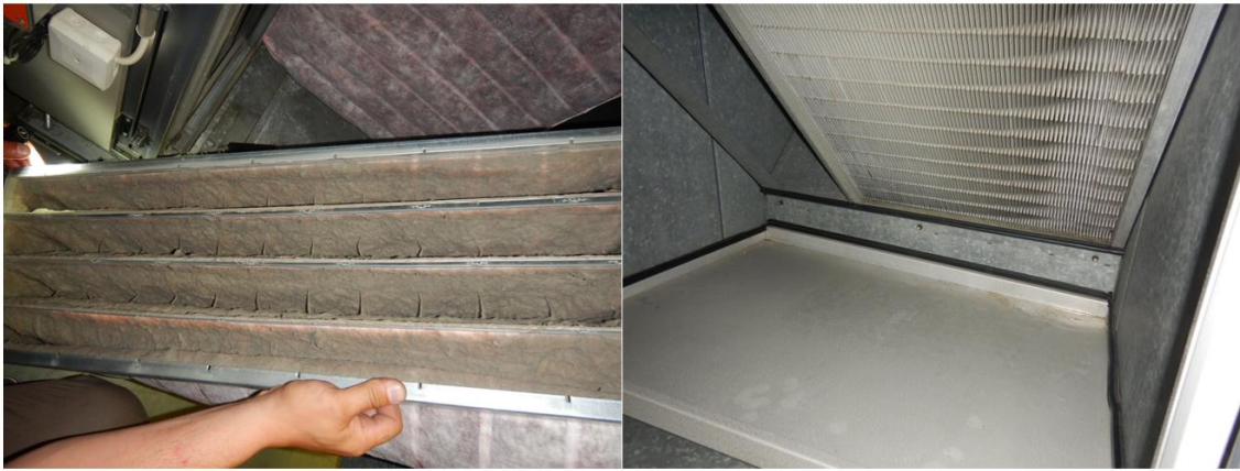
Kuva 103. Noin neljä kuukautta sitten vaihdetut suodattimet olivat sisäpinnoiltaan jo melko likaiset. Koneen lämmönvaihdinpinnat olivat silmämääräisesti puhtaat.
