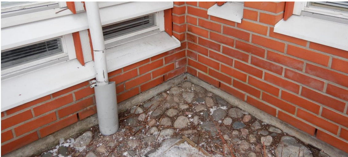
Kuva 57. Tekstiilityöluokan ja luokkahuoneen 172 välinen nurkkaus ulkopuolelta. Seinissä näkyy merkkejä kosteusrasituksesta.
