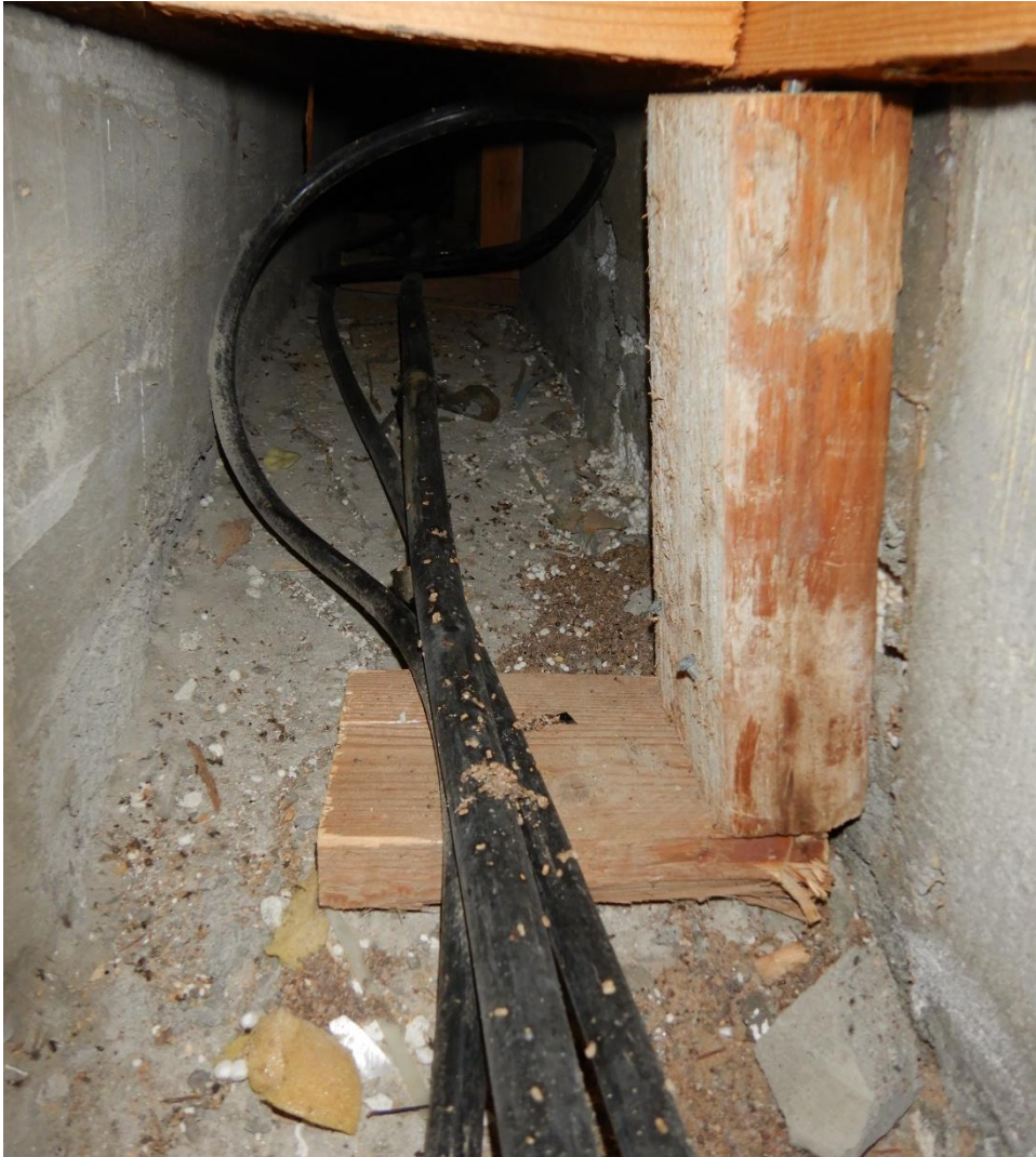
Kuva 100. Sähköpääkeskukseen tuleva kaapelikuilu, puiset rakenteet kosteusvaurioituneet.
