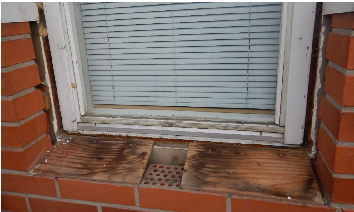
Kuva 61. Ikkunoita ympäröivissä rakenteissa runsaasti vesijälkiä.
