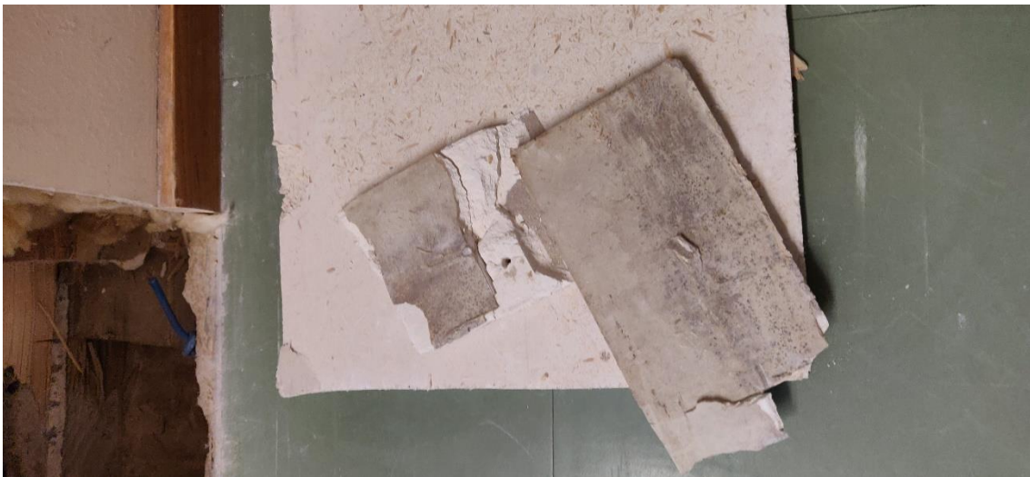
Kuva 44. Rakenneavaus S2 luokan 115 käytävän vastaiseen seinään. Kipsilevyssä on silminnähtävää mikrobikasvustoa.
