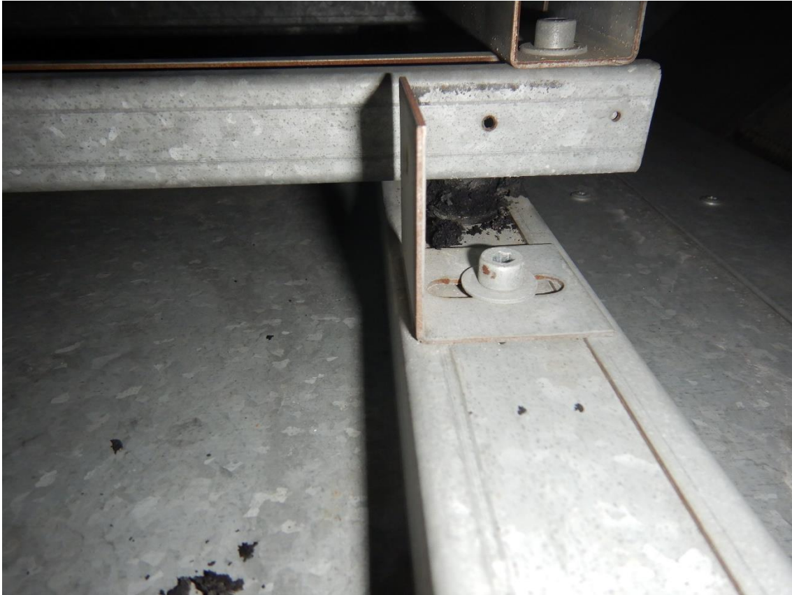
Kuva 101. Puhallinkojeen moottorin tärinän vaimentimet olivat huonokuntoiset.
