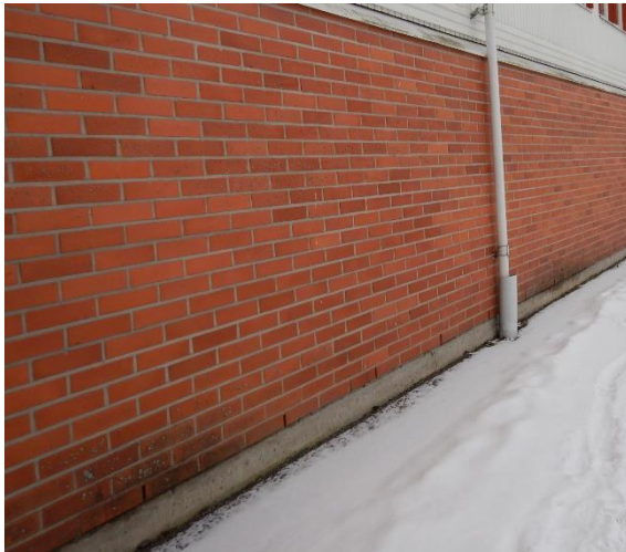
Kuva 74. Liikuntasalin ulkoseinän alaosassa todettiin kosteusvaurioon viittaavia tummia jälkiä.
