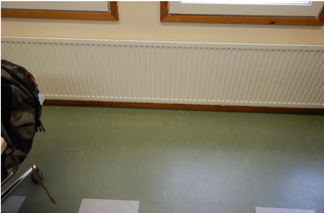
Kuva 87. Huoneen 103 vinyylilaatat ovat osin irti ulkoseinustalla.
