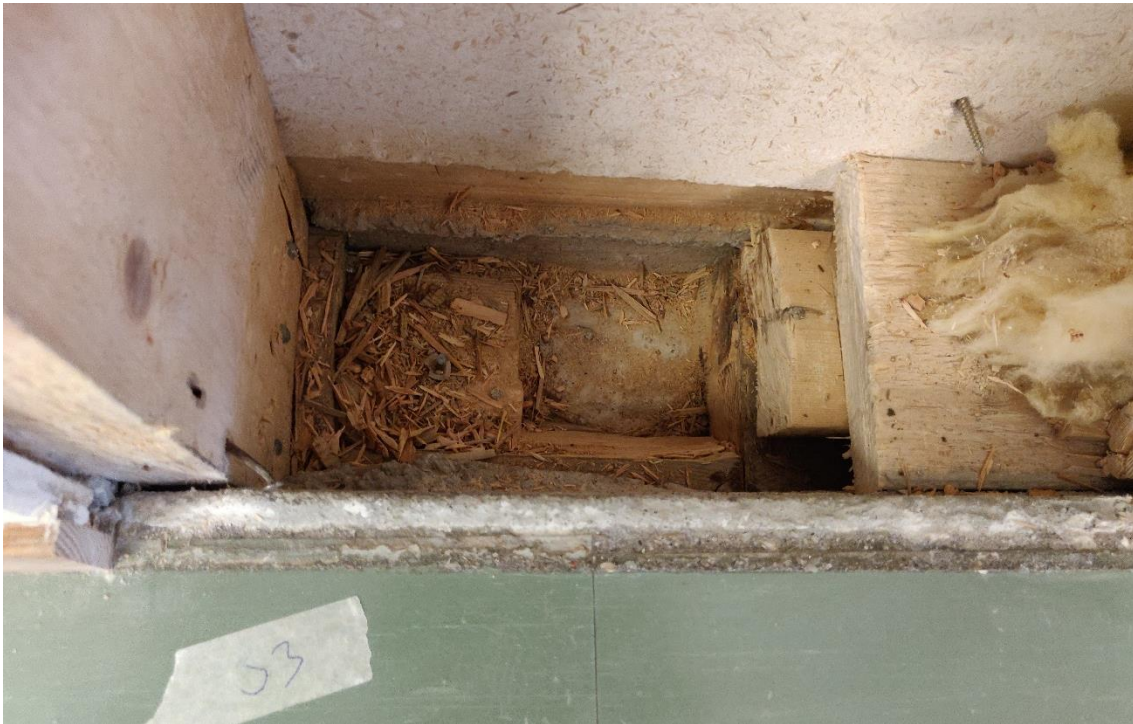
Kuva 43. Rakenneavaus S3 liikuntasalin seinässä. Rakenne poikkeaa suunnitelmista.
