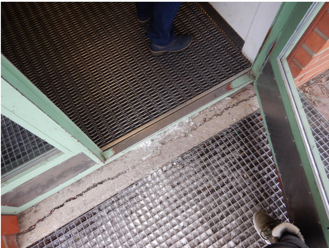
Kuva 63. Sadevedellä pääsy sokkelihalkaisun eristetilaan halkeamasta.
