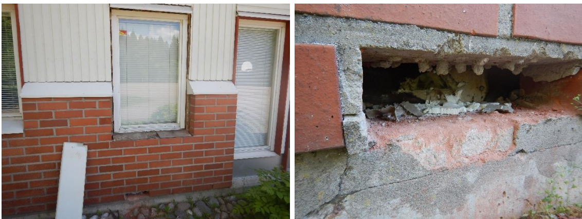
Kuva 56 a-b. Sokkelin päällä oleva bitumihuopa kääntyy tuulensuojalevyä vasten. Sitä ei kuitenkaan ole liimattu kiinni.
