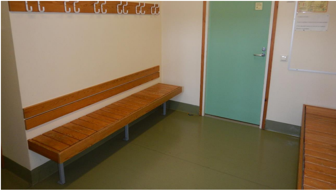
Kuva 86. Pukuhuoneissa lattiamatto on nostettu seinille noin 10cm.
