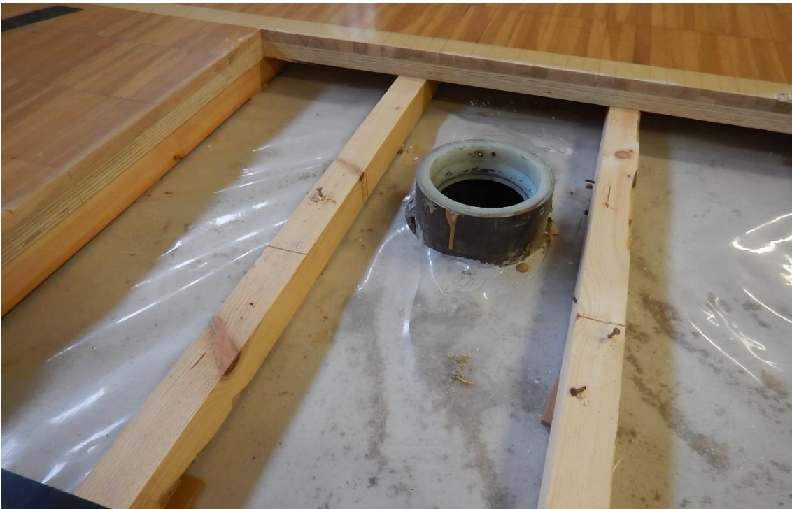
Kuva 30. Liikuntasalin lattian jatkoavaus. Muovin alla on puun sahauspurua.
