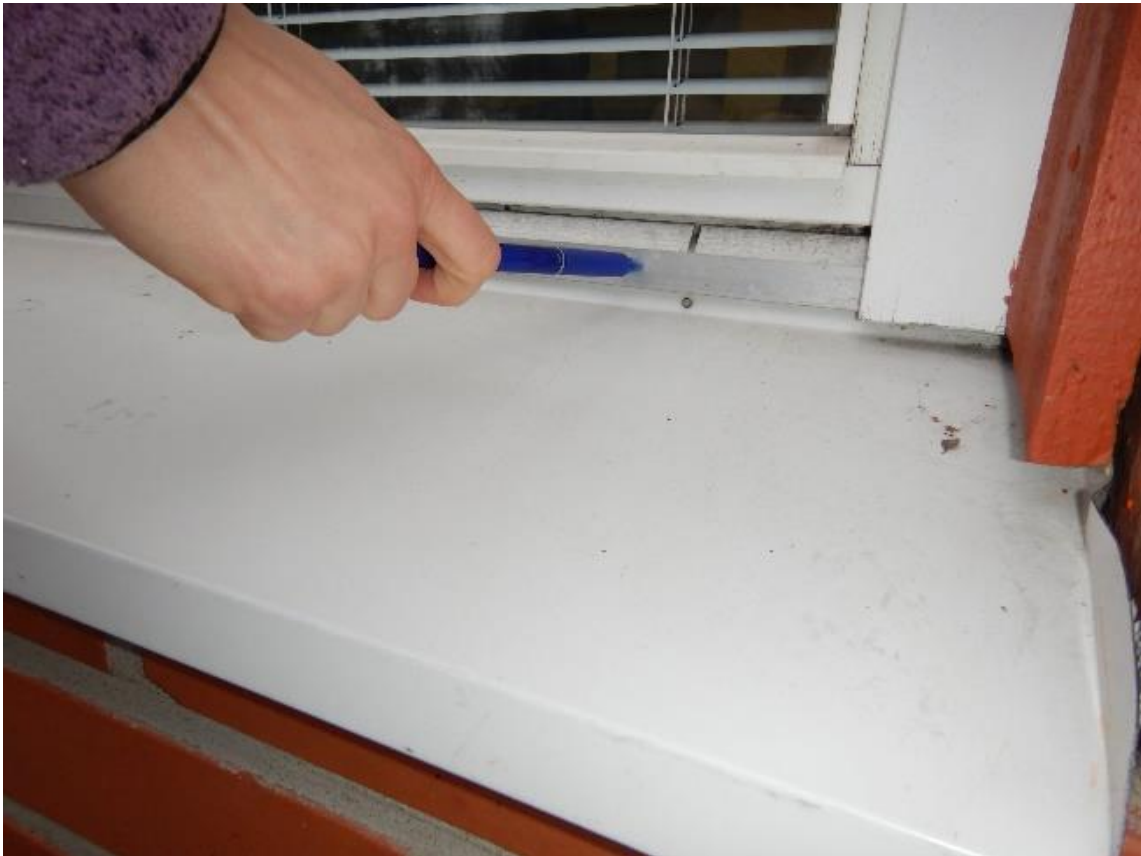
Kuva 60. Ikkunoiden pellityksien limitykset eivät välttämättä ole riittäviä. Lisäksi pellin liittymistä muihin rakenteisiin ei ole varmistettu esimerkiksi kittaamalla.
