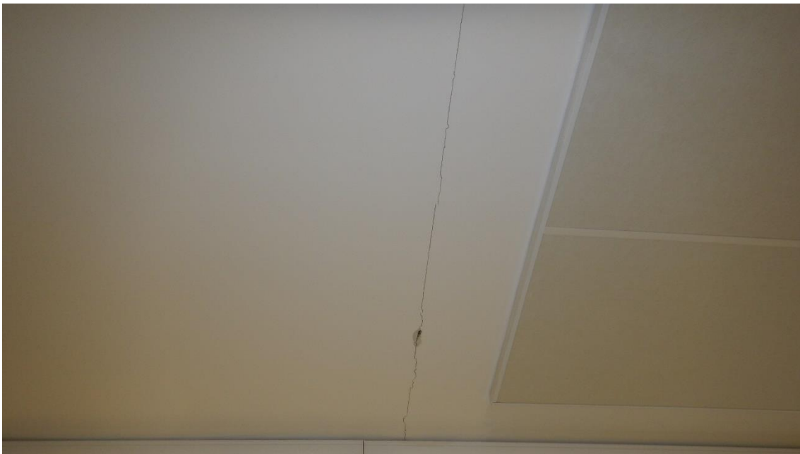
Kuva 92. Käsityöluokan kattolevyt ovat ratkeilleet saumoista.
