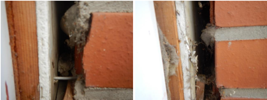
Kuva 55 a-b. Muurauksen laastipurseet tukkivat paikoitellen tuuletusraon ulkoseinässä. Toisin paikoin rako on niin suuri, että tuuletus toimii, vaikka laastipurseitakin on.
