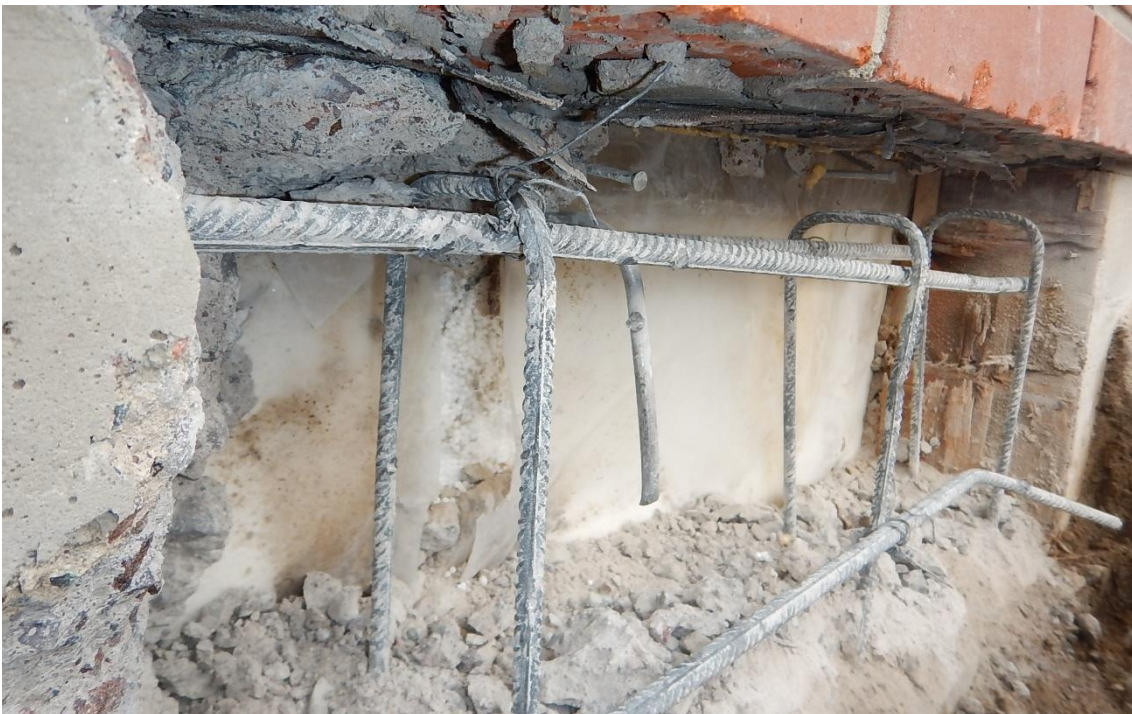
Kuva 24. Kuvassa on esitetty sokkeliavaus SK103. EPS eristeessä on silmin havaittavia mikrobivaurioita. Halkaisussa ei havaittu puukappaleita tms. Liikuntasauaman vanerissa on laho- vaurioita.
