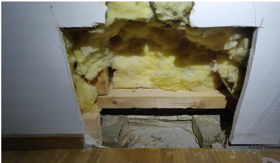
Kuva 83. Näyttämön ja talonmiehen asunnon välisen seinän rakenneavaus silmämääräisesti hyväkuntoinen, joskin seinälevy rikkoutunut mekaanisen iskun johdosta.
