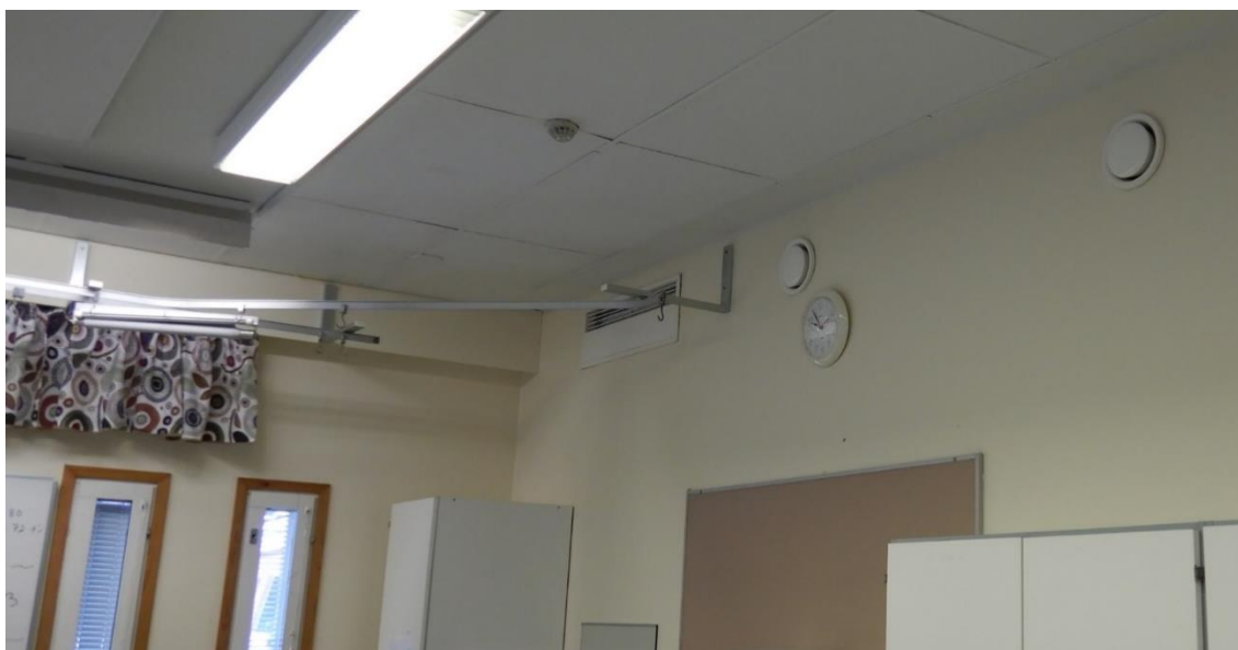
Kuva 105. Luokassa 103 on tuloilmapäätteen edessä kiskoja ja lamppu, joiden päätteen puoleiset pinnat ovat selkeästi pölyntyneitä. Tuloilma ei pääse kulkemaan huonetilassa suunnitellusti vaan saattaa päätyä lähellä oleviin poistoelimiin.
