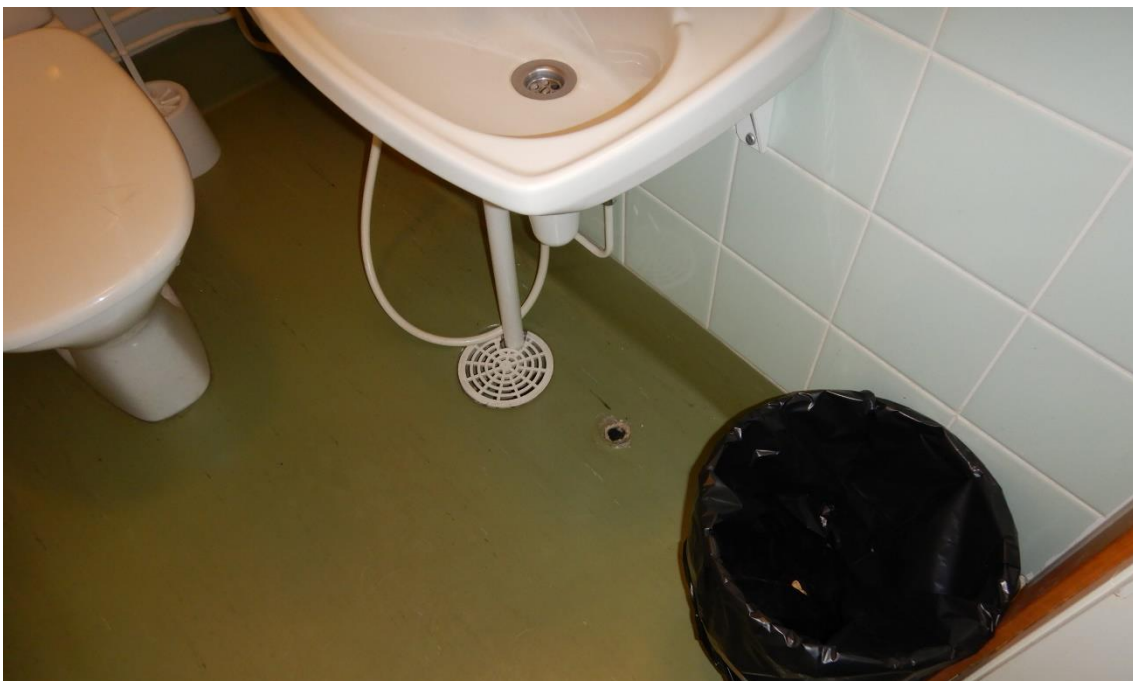
Kuva 85. Lattiassa on avoin läpivienti.
