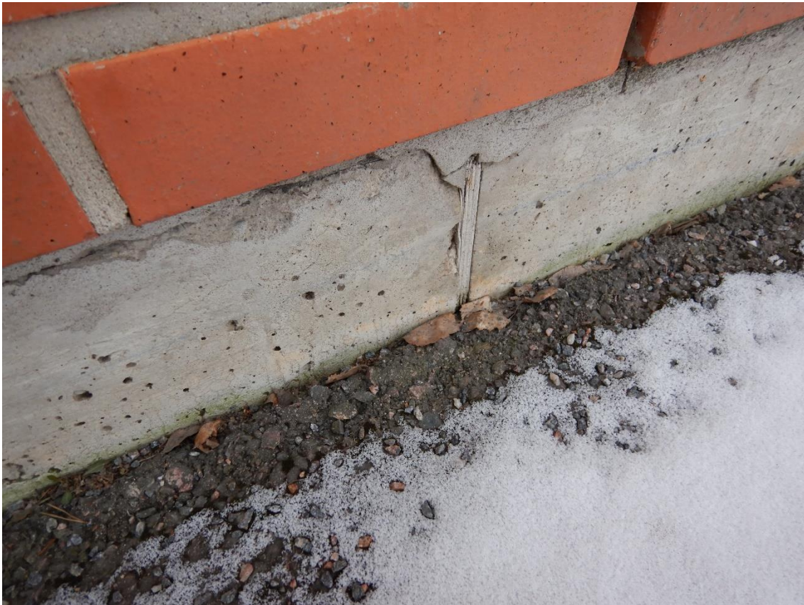
Kuva 50. Liikuntasauvojen tilkemateriaalina perustuksissa on käytetty vaneria.
