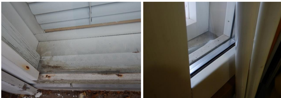
Kuva 59. Etelänpuolen ikkunoista suurin osa on kosteusvaurioituneita, pohjoispuolen ikkunat ovat paremmassa kunnossa.
