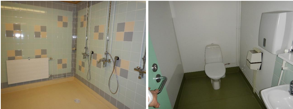
Kuva 97. Liikuntasalin yhteydessä olevien märkätilojen kunto on tyydyttävä.
