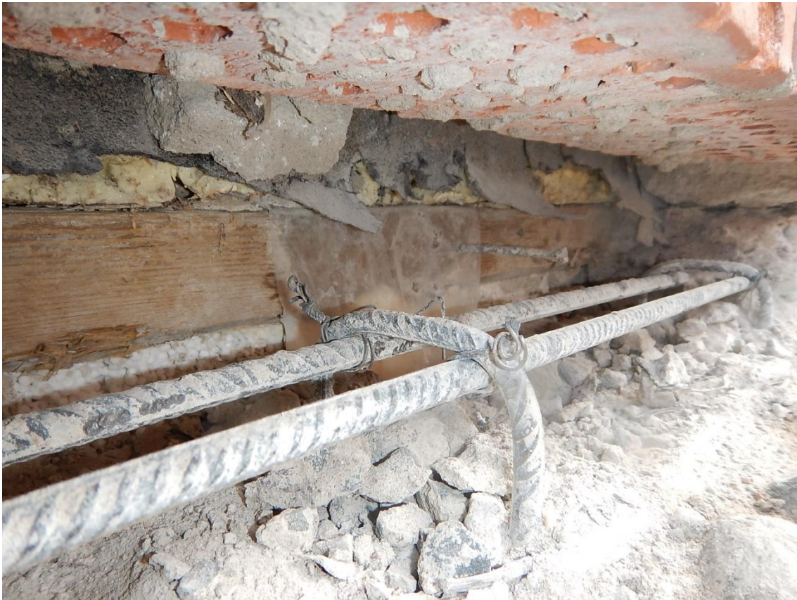
Kuva 22. Kuvassa on esitetty sokkeliavaus SK100. Avauksesta havaittiin ulkoseinän alajuoksussa silmin havaittavia mikrobivaurioita.
