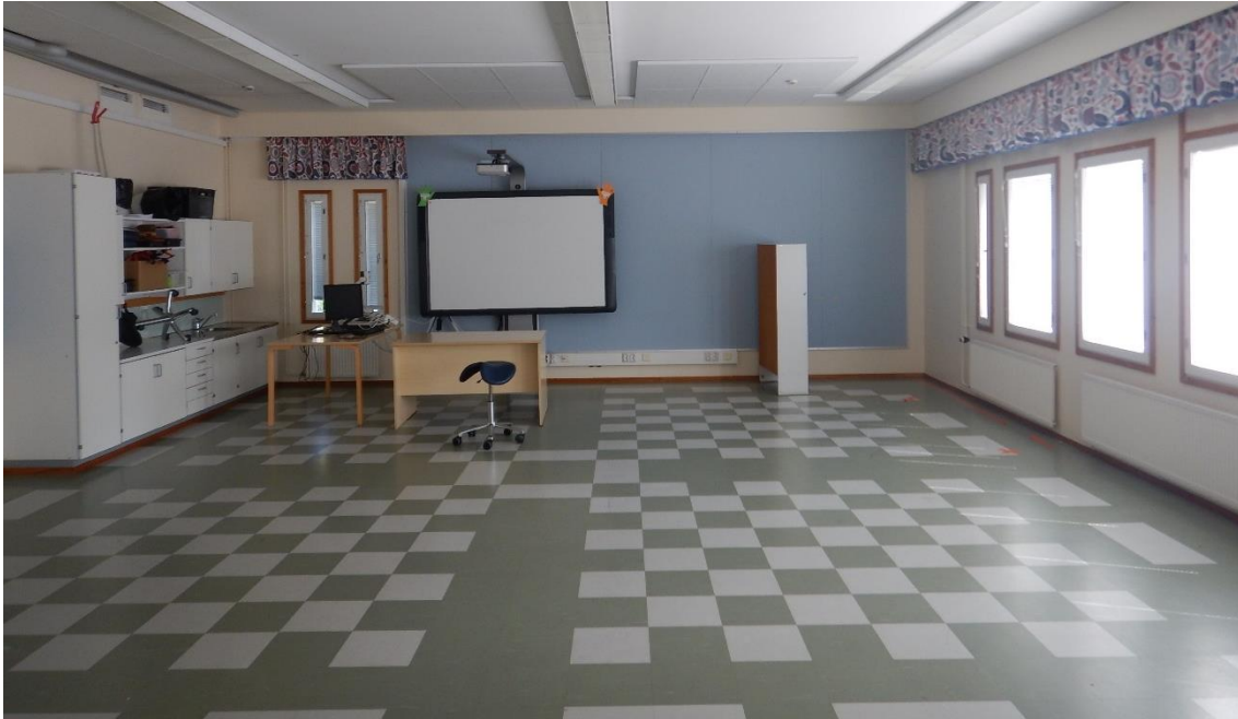
Kuva 84. Lattiapinnoitteet suurimmalta osalta tyydyttävässä kunnossa.
